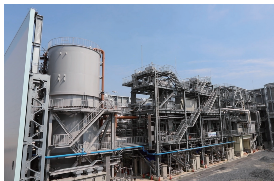
空見スラッジリサイクルセンター下水汚泥固形燃料化 事業 (名古屋市上下水道局) PFI (BTO) 方式
